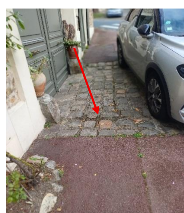
DEFAUTS DE JOINTURE PAVES (GRANDE RUE)
