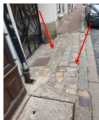
INCLINAISON TROTTOIR, DEFAUT DE JOINTURE (GRANDE RUE)
