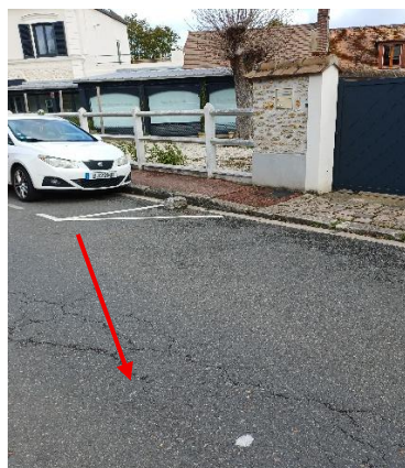
FISSURES (RUE DE LA MAIRIE)
