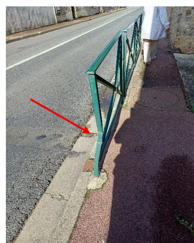
REMBARDE ENDOMMAGE PROBABLEMENT PAR UN POIDS LOURD (RUE DE LA MAIRIE)
