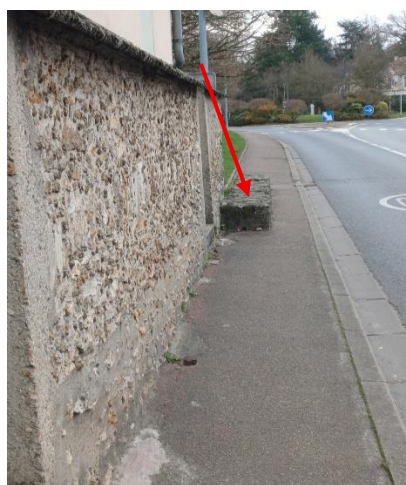
OBSTRUCTION DE LA CIRCULATION PAR UN MURET (RUE DE LA MAIRIE)
