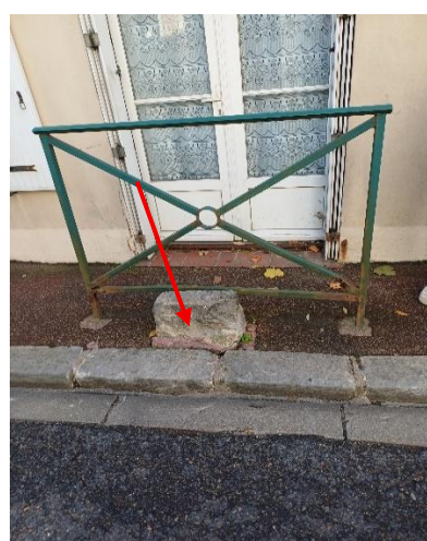
REMBARDE AU MILIEU DU TROTTOIR DÛ A LA PRESENCE D'UNE BORNE (RUE DE LA CROIX BLANCHE)
