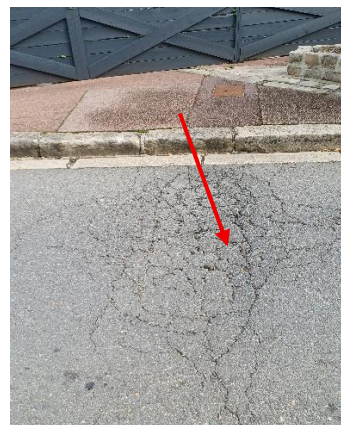
FISSURES (RUE DE LA MAIRIE)
