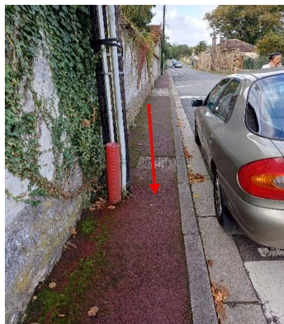
LARGEUR TROTTOIR INSUFFISANT
