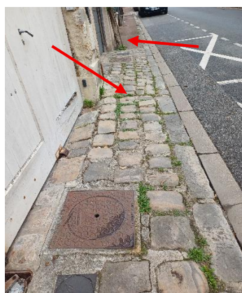
RETRECISSEMENT ET DEFAUT DE JOINTURE PAVES (GRANDE RUE)
