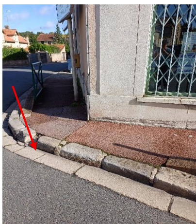
LARGEUR TROTTOIR INSUFFISANT. ABSENCE DE RAMBARDE DE PROTECTION (GRANDE RUE)
