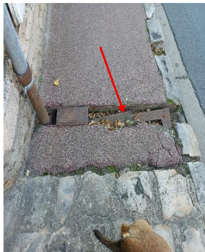
EFFONDREMENT PLAQUE D'EGOUT
