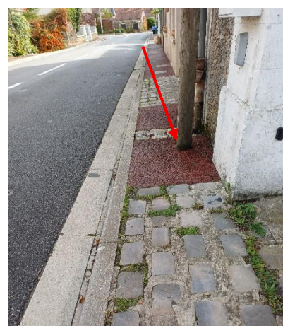
LARGEUR TROTTOIR INSUFFISANT (RTE HOUDAN)
