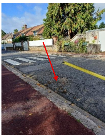
FISSURES (RUE DE LA CROIX BLANCHE)
