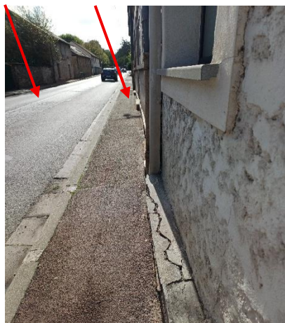
LARGEUR TROTTOIR INSUFFISANT (RUE DE LA MAIRIE)
