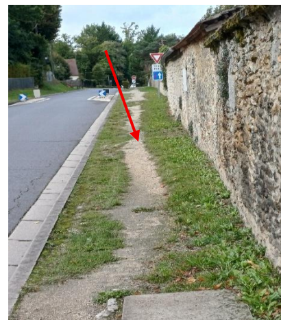
ABSENCE DE TROTTOIR STABILISE
