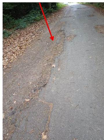
ABAISSMENT DE LA CHAUSSEE (RTE DE (RTE DE LA VIGNERIE)
