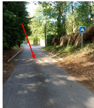
RALENTISSEUR SITUE EN DEHORS D'UNE ZONE 30. ZONE MAL ECLAIREE (CHEMIN DE NOGENT)
