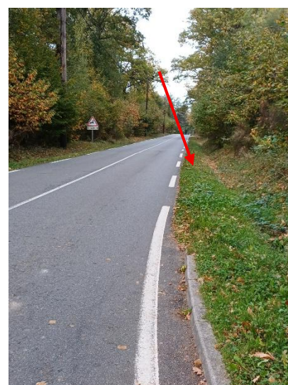
ABSENCE DE TROTTOIR
